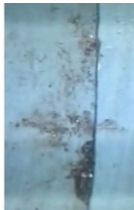
Rys. 1. Nieszczelne złącze (źródło: przedsiębiorstwo wodociągów i kanalizacji)
