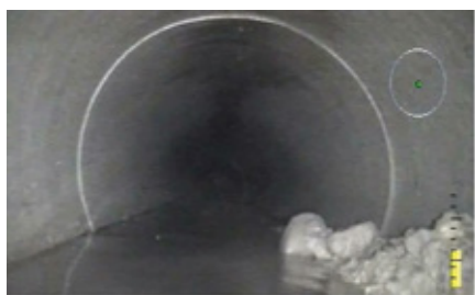
Rys. 6. Osady, gruz (źródło: przedsiębiorstwo wodociągów i kanalizacji)
