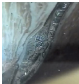
Rys. 4. Wypchnięte uszczelnienie (źródło: przedsiębiorstwo wodociągów i kanalizacji)
