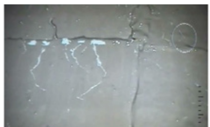
Rys. 7. Pęknięcie poprzeczne (źródło: przedsiębiorstwo wodociągów i kanalizacji)
