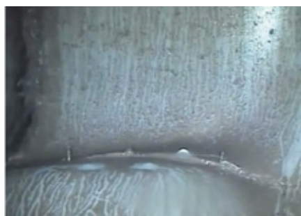
Rys. 8. Wybrzuszenie ściany rury (źródło: przedsiębiorstwo wodociągów i kanalizacji)
