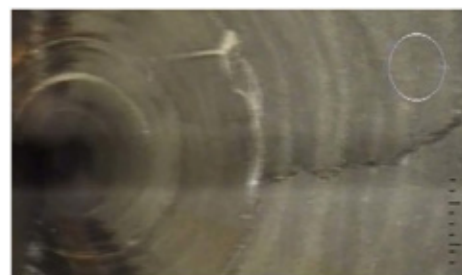
Rys. 3. Pęknięcie podłużne w odległości 0,5 m od początku pomiaru (źródło: przedsiębiorstwo wodociągów i kanalizacji)
