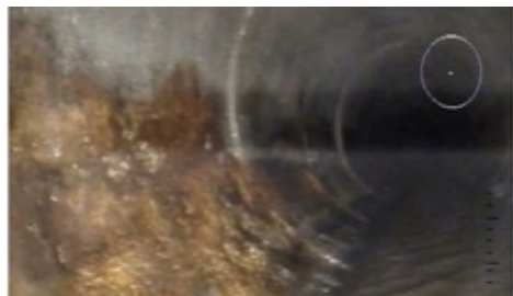
Rys. 4. Korozja ściany (źródło: przedsiębiorstwo wodociągów i kanalizacji)
