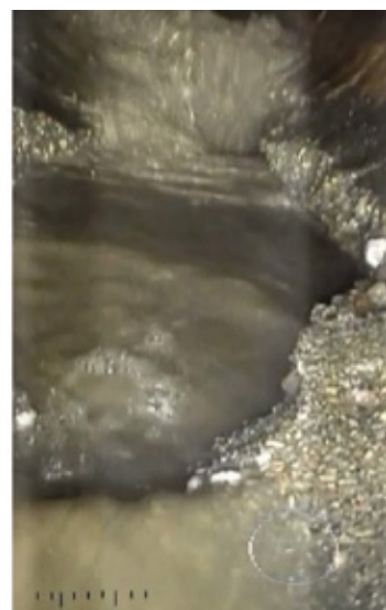
Rys. 7. Zapadnięcie dna w odległości 11,9 m od początku pomiaru (źródło: przedsiębiorstwo wodociągów i kanalizacji)
