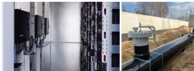
Rys. 3 Magazyn energii 180 kW/400 kWh
