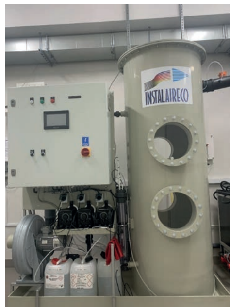
Fig. 1. Research installation INSTAL AIRECO Rys. 1. Instalacja badawcza INSTAL AIRECO
