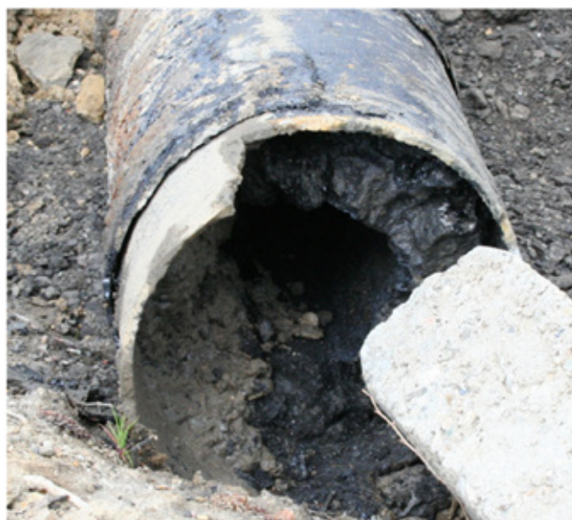
Rys. 3. Odcinek gazociągu stalowego DN 250 silnie zanieczyszczony naftalenem Fig. 3. Section of a DN250 steel gas pipeline heavily contaminated with naphthalene
