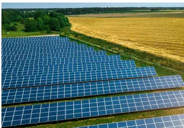
Rys. 2. Farma fotowoltaiczna[10] Fig.2. Photovoltaic ferm [10]
