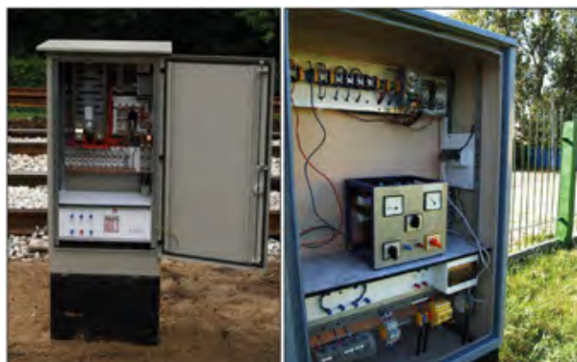
Rys. 10. Stacja SOK w Warszawie na gazociągu średniego ciśnienia Fig. 10. SOK station in Warsaw on medium-pressure gas pipeline Źródło: MSG Sp. z o. o.
