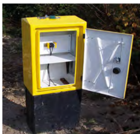
Rys. 12. Punkt pomiarowy w obudowie Fig. 12. Measuring point in housing Źródło: MSG Sp. z o. o.
