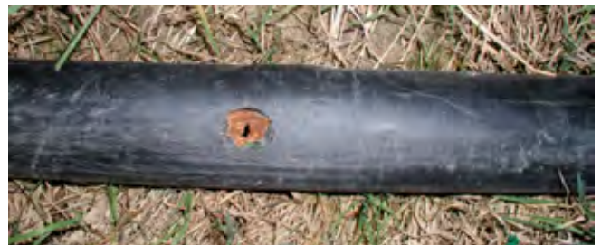
Rys. 14. Typowe uszkodzenie rurociągu wywołane przez prądy błądzące Fig. 14. Typical pipeline damage caused by stray currents Źródło: MSG Sp. z o. o.
