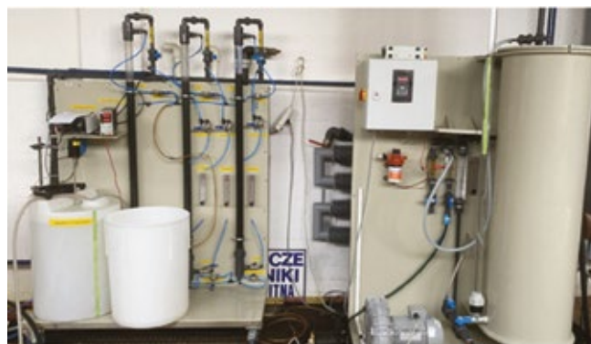
Rys. 2. Instalacja mobilna do napowietrzania i filtracji Fig. 2. Mobile installation for aeration and filtration
