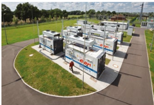
Fot. 1. Instalacja elektrolizerów w Falkenhagen, Niemcy (źr. E.ON) Photo 1. Electrolyzer plant in Falkenhagen, Germany (source. E.ON)
