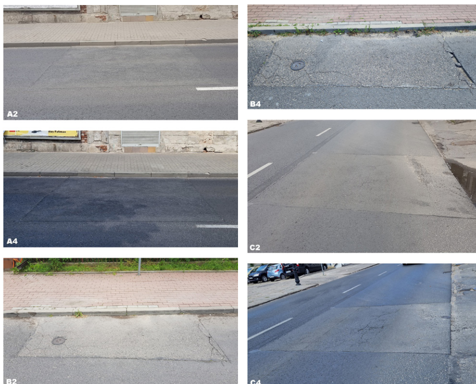
Fot. 1. Badane nawierzchnie i ich stan po 2 latach (A2, B2, C2) i 4 latach (A4, B4, C4) od wykonania. A – nawierzchnia wykonana poprawnie, bez uszkodzeń; B – nawierzchnia kwalifikująca się do remontu już po 2 latach od wykonania; C – nawierzchnia wymagająca zabiegów utrzymaniowych po 2 latach i kwalifikująca się do remontu po 4 latach.
