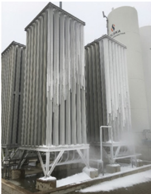
Rys. 18. Obłędzenie parownic atmosferycznych (zdjęcie Andrzej Żero) Fig. 18. Icing of atmospheric evaporators (photo by Andrzej Żero)
