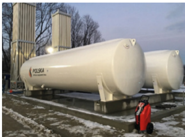
Rys. 16. Stacja regazyfikacji LNG ze zbiornikami poziomymi (zdjęcie Andrzej Żero)
