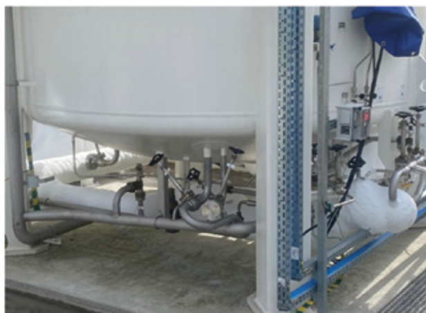
Rys. 17. Oblodzenie instalacji około zbiornikowej (zdjęcie Andrzej Żero)
