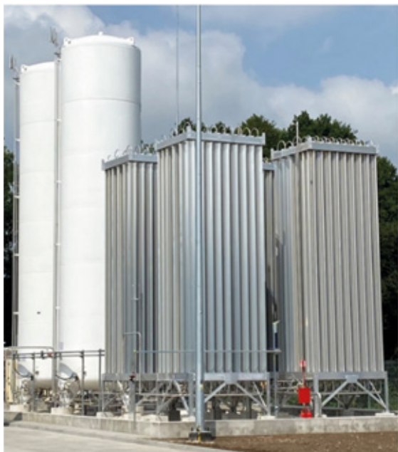
Rys. 15. Przykład stacji regazyfikacji LNG zasilającej wyspowy obszar dystrybucyjny (zdjęcie Andrzej Żero)
