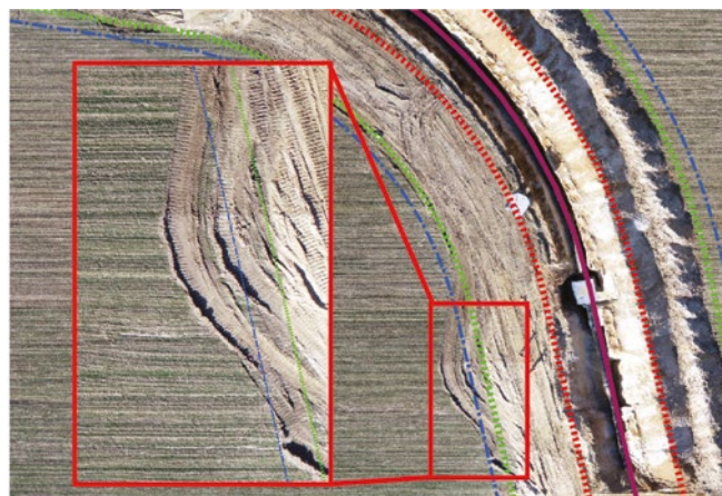
Rys. 5: Naruszenie pasa budowlano-montażowego (linia zielona) i terenu objętego decyzją lokalizacyjną (linia niebieska) w wyniku przejazdu sprzętem ciężkim.
