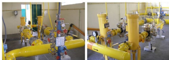
Rys. 7 Widok ciągów redukcyjnych oraz jednostki wykonawczej LC-21 [3].
