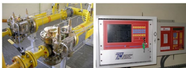
Rys. 8. Widok urządzeń redukcyjno-zabezpieczających CRONOS oraz jednostki sterującej LC-21 [3].
