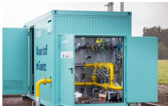
Rys. 1. Instalacja zatłaczania wodoru do sieci. (Avacon) źródło: https://hydrogen-central.com/eon-avacon-dvgw-20-percent-hydrogen-german-gas-network/
