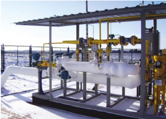
Rys. 3. Stacja gazowa bez podgrzewu gazu z zastosowaniem urządzeń umożliwiających prawidłową pracę stacji. Fig. 3. Natural gas reduction station without heating with the use of devices enabling the correct operation of the station.
