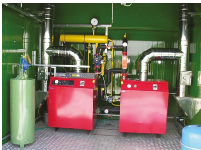
Rys. 8. Kotłownia na stacji gazowej.
