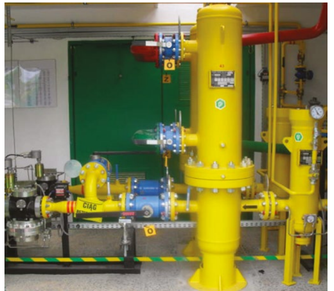
Rys. 6. Podgrzewacz gazu na zamontowany na stacji gazowej. Fig. 6. Gas heater installed on the natural gas reduction station.
