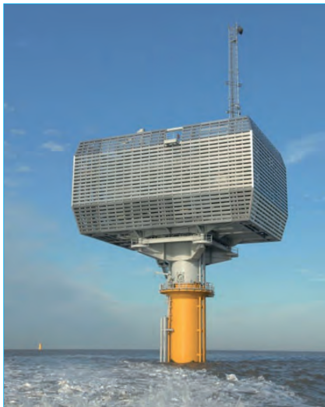
Rys. 8. Podstacja morska dla dużej farmy wiatrowej [3]
