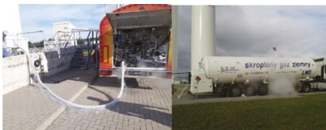
Rys. 17. Oszronienie węzła oraz mgła podczas tankowania stacji regazyfikacji (źródło: zdjęcia własne) Fig. 17. Frosting of the cryogenic hose and fog (source: own pictures)
