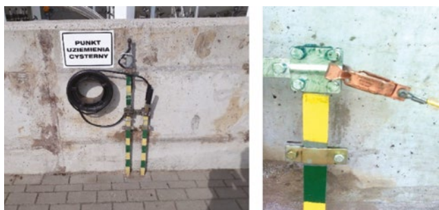
Rys. 11. Punkt uziemienia (źródło: zdjęcia własne) Fig. 11. Point of ground (source: own pictures)
