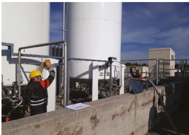
Rys. 14. Przedmuchiwanie instalacji azotem (źródło: zdjęcie własne) Fig. 14. Purging wit nitrogen (source: own picture)
