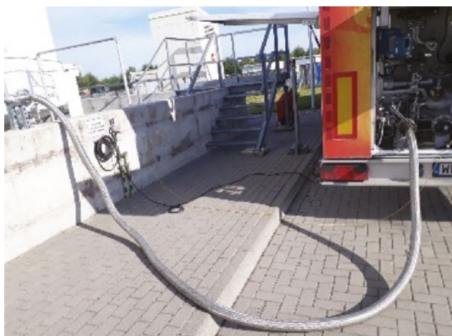
Rys. 12. Instalacja LNG połączona wężem elastycznym z autocysterną (źródło: zdjęcia własne)
